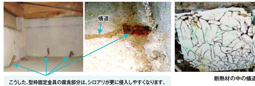
こうした、型枠固定金具の腐食部分は、シロアリが更に侵入しやすくなります。
